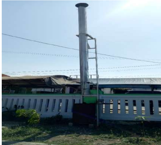
Gambar 2. Cerobong sampah di Kantor Desa Kramatwatu
