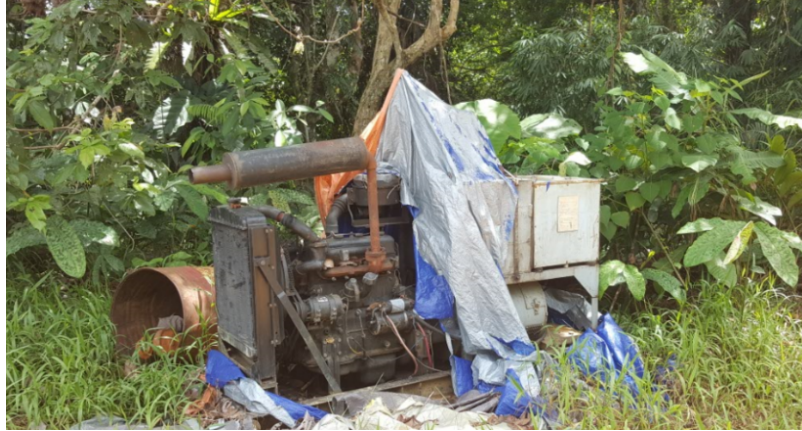
Gambar 9. Pompa Air yang belum difungsikan di Long Pahangai Sumber: Peneliti, 2024
