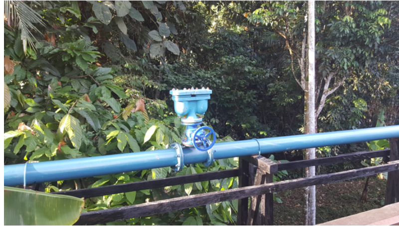
Gambar 11. Pipa Distribusi Air di Long Apari yang tidak berfungsi Sumber: Peneliti, 2024
